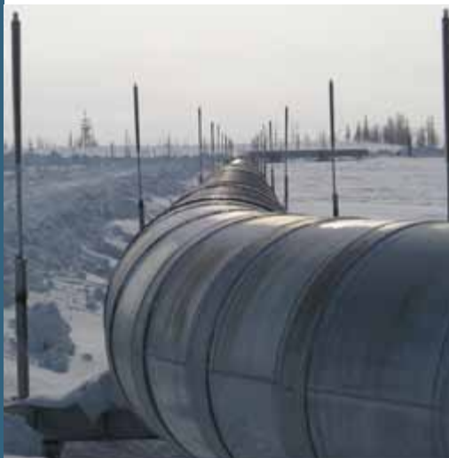
Нефтепровод «Ванкор-НПС Пуриле». Надземная прокладка с применением термостабилизаторов
