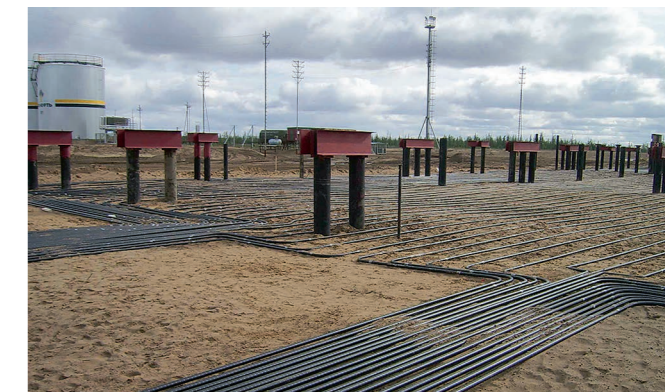
Смонтированные охлаждающие трубы системы
