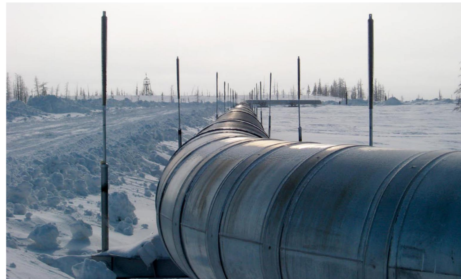
Нефтепровод Ванкор – Пурпе на участке 0–20 км. Надземная прокладка, термостабилизаторы в сваях опорных конструкций.
