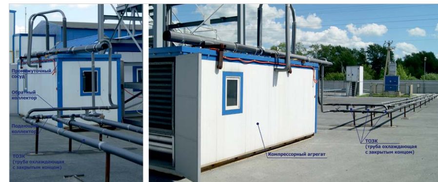
Рис. 3 — Система горизонтальная труба в трубе (ГТТ), в составе с компрессорно-конденсаторным агрегатом. Опытно-промышленный мерзлотный полигон, Тюмень Fig. 3 — The horizontal pipe-in-pipe system (GTT), composed of a condensing unit. Experimental industrial permafrost, Tyumen
