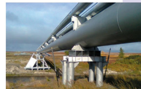
Рис. 3. Индивидуальные термостабилизаторы в основании балочного перехода, Ямбургское НГКМ
