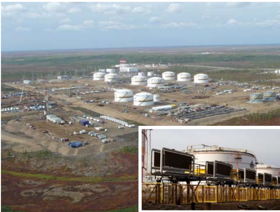
Системы «ГЕТ» в основании резервуарного парка. Ванкорское месторождение
