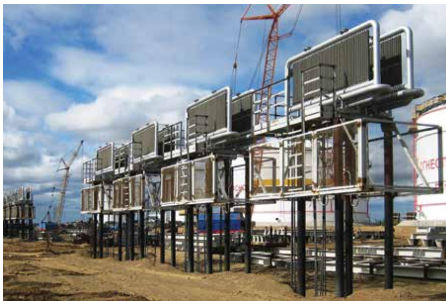
Системы ГЕТ и ВЕТ в основании резервуарного парка. Ванкорское НГКМ
