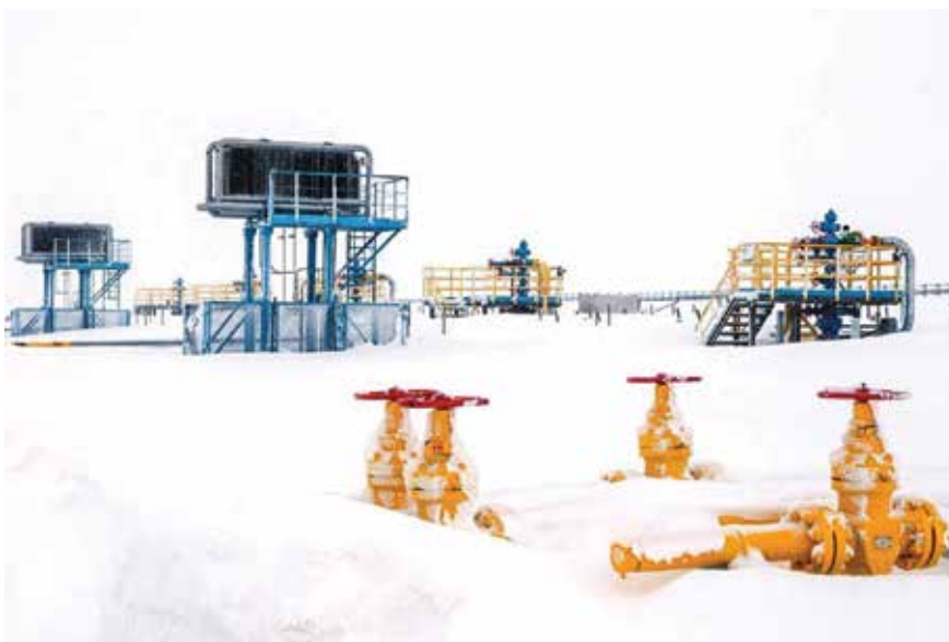
Система ВЕТ в приустьевой зоне скважины. Бованенковское НГКМ
