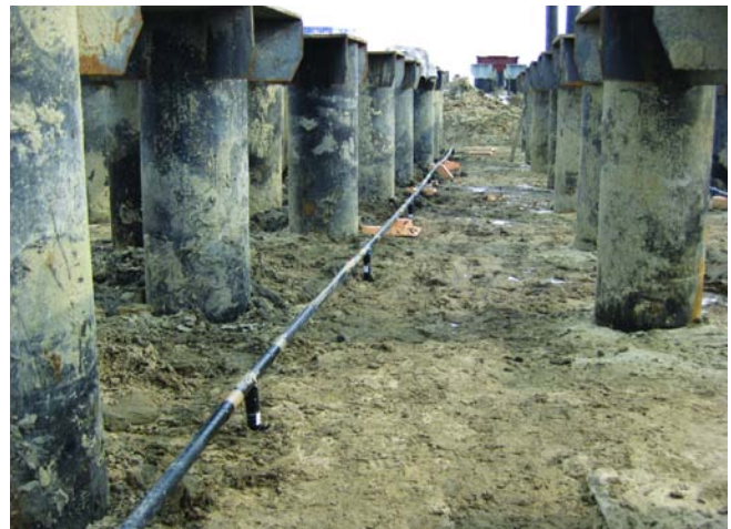
Термостабилизация системами ВЕТ в основании производственного корпуса на Бованенковском нефтегазоконденсатном месторождении
