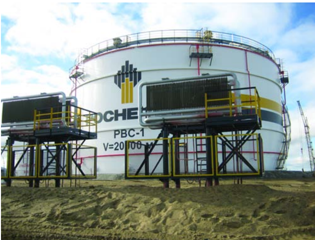
Термостабилизация основания РВС системами ГЕТ (видна надземная часть системы – конденсаторные блоки)
