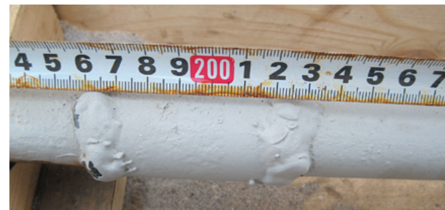
Рис. 3. Несоответствие сварных швов нормативным требованиям
