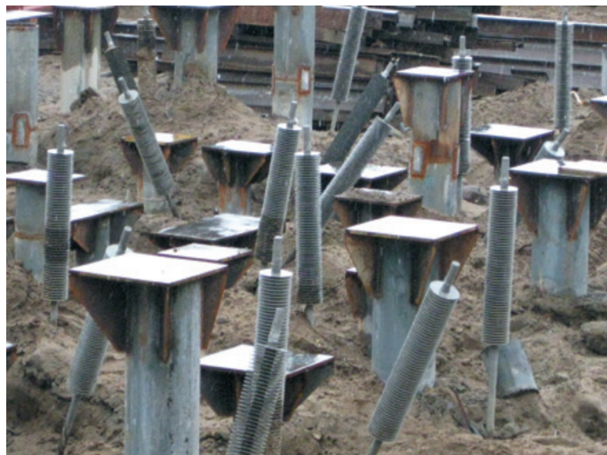
Рис. 7. Некачественная установка термостабилизаторов
