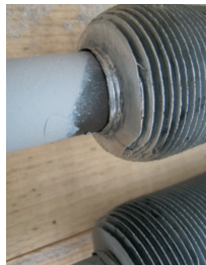
Рис. 1. Отсутствие антикоррозийного покрытия на участках корпуса термостабилизатора
