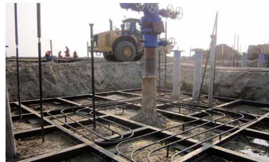
Рис. 2. Система охлаждения грунтов ВЕТ на опорной раме
