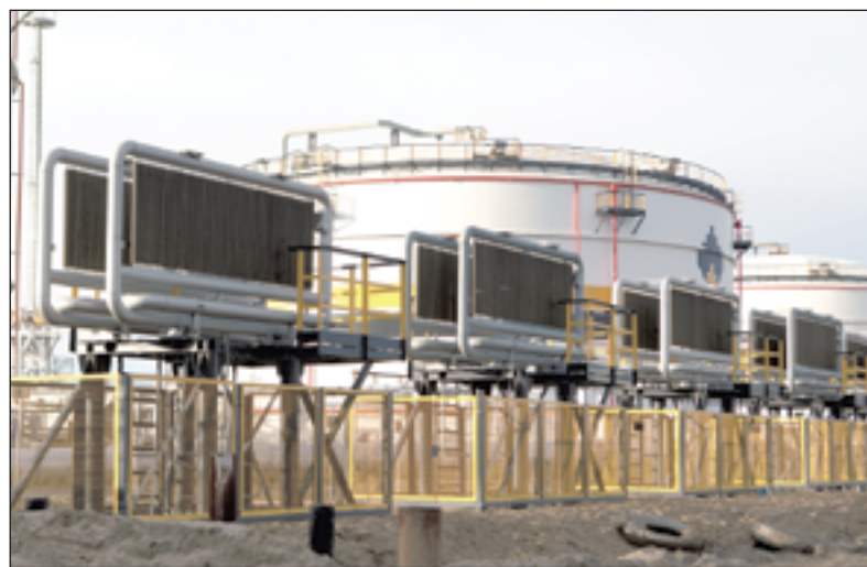
Системы ГЕТ в основании резервуарного парка. Ванкорское месторождение.
