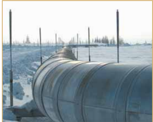
Термостабилизаторы, изготовленные НПО «Фундаментстройаркос», установлены совместно со сваями. Нефтепровод Ванкор — Пурпе
