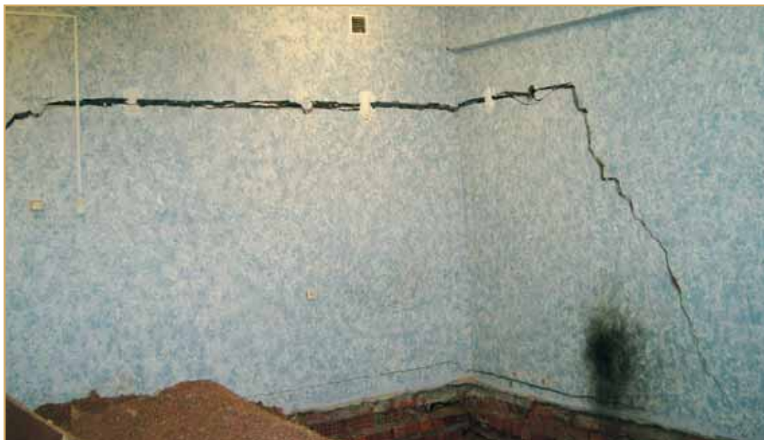
Деформации здания АХЧ аэропорта г. Салехарда после года эксплуатации
