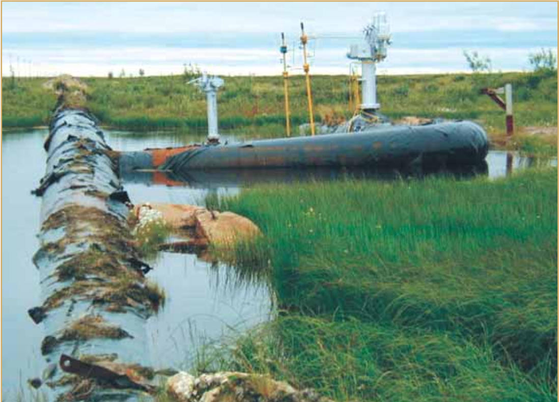
Деформация магистрального трубопровода на участке КС «Ямбургская» — КС «Ныдинская». Формирование термокарстового озера
