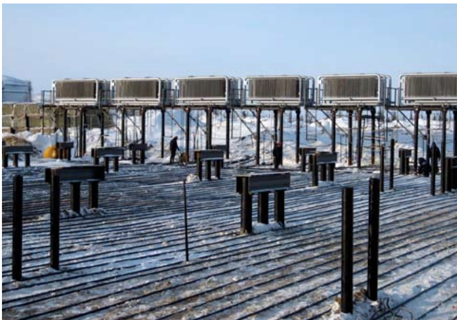
Надежность оснований зданий и резервуаров достигается шагом размещения охлаждающих труб и дополнительным размещением резервных труб для подключения при необходимости передвижной холодильной машины
