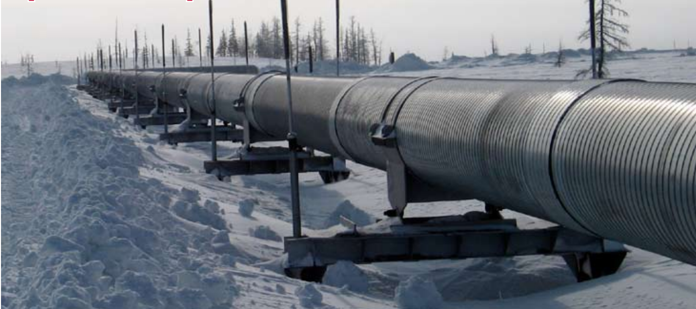
Опоры нефтепровода надежно вморожены в грунт за счет термостабилизаторов
