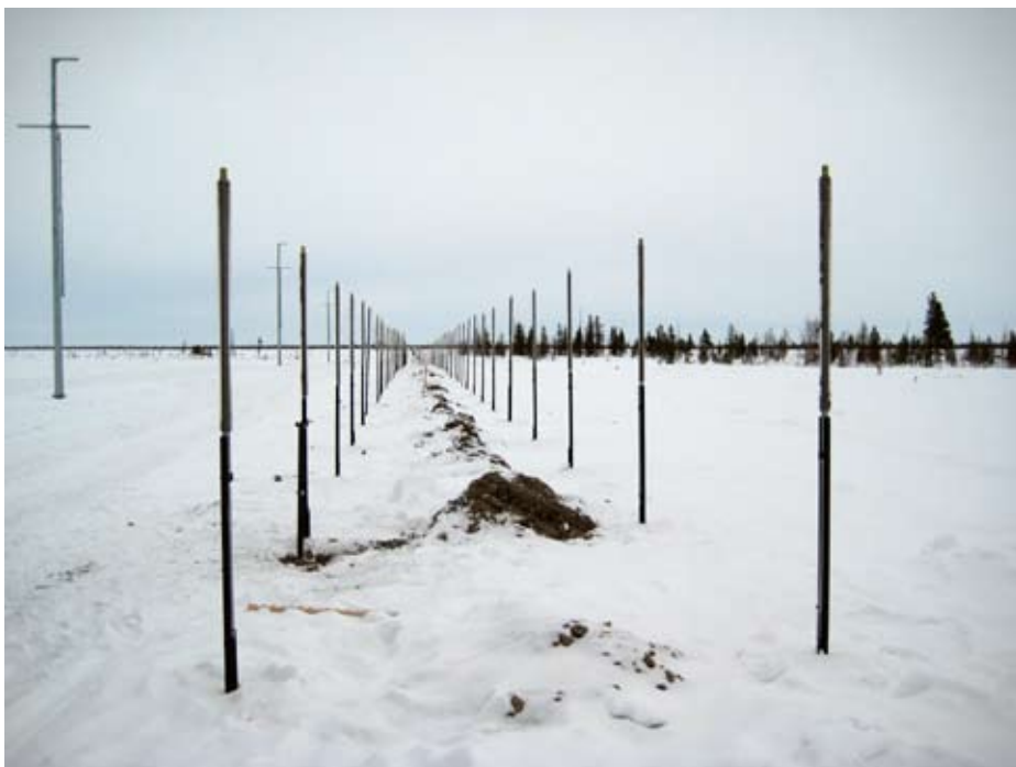
Устойчивость и надежность нефтепровода при подземной прокладке на участках вечномёрзлых грунтов обеспечивается термостабилизаторами
